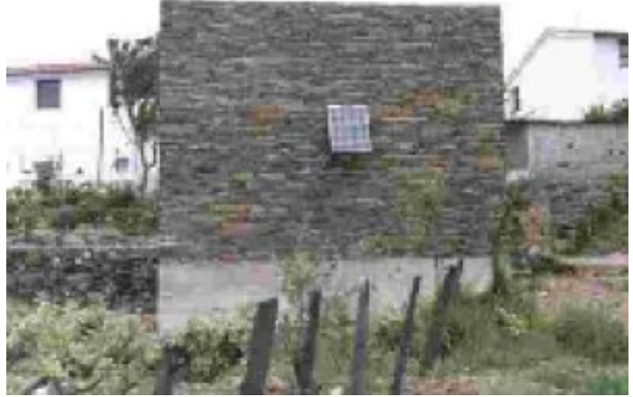
PRZYSTANEK Z SYSTEMEM FOTOWOLTAICZNYM 1
