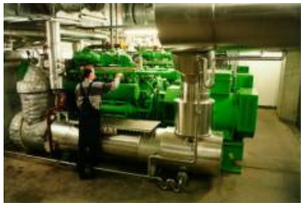
INSTALATIA CHP DE LA GRADINA BOTANICA
