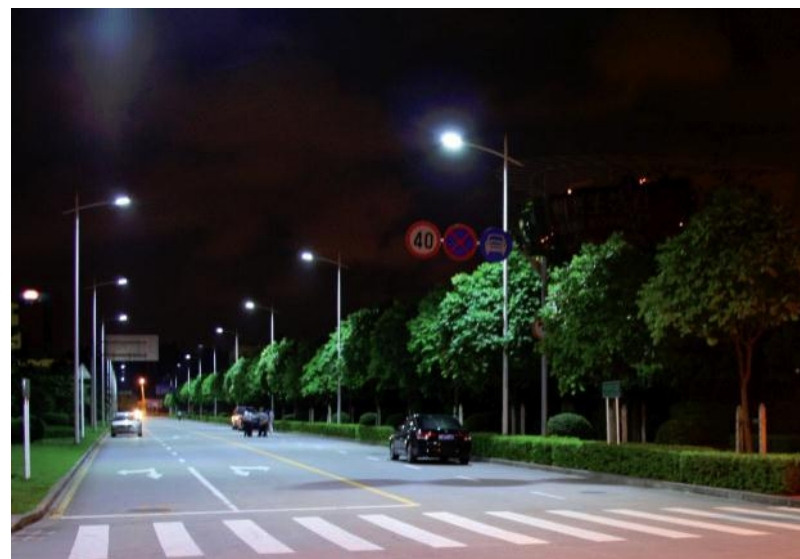
Maintenant : lampadaires à LED 120 W
